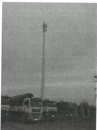
Widok obiektu wraz z zainstalowanym zespołem antenowym
