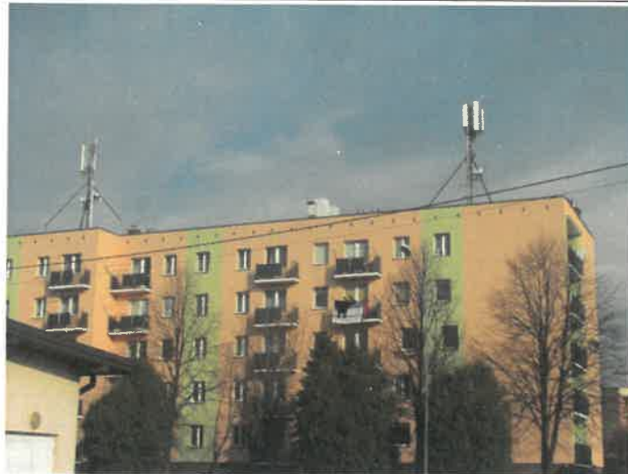
Zał. nr 1: Widok ogólny instalacji radiokomunikacyjnej.
