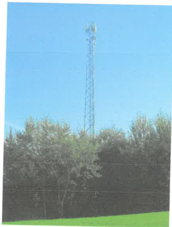
Zał. nr 1: Widok ogólny instalacji radiokomunikacyjnej.
