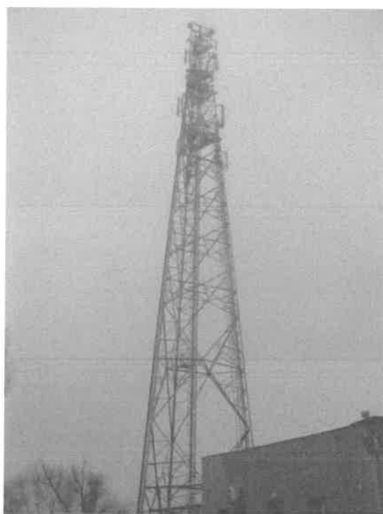
Zał. nr 1: Widok ogólny instalacji radiokomunikacyjnej.
